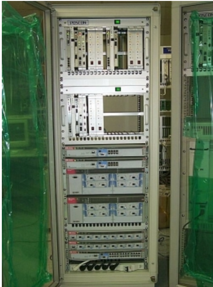
그림 2. PCS, P-CCS 통신(Modbus+ 통신)의 Cabinet 모양
